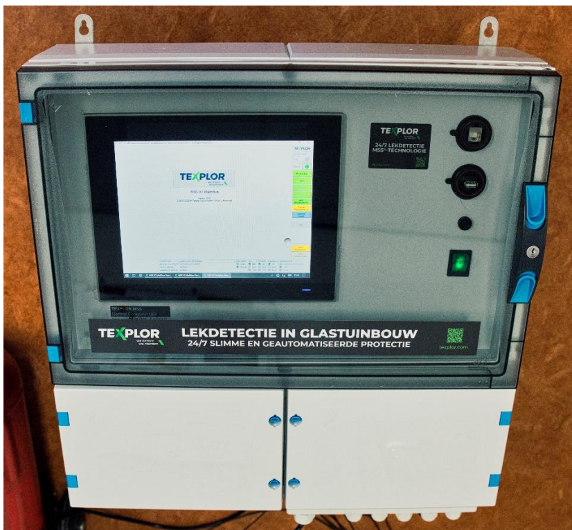
Afbeelding 4: besturingskast automatische lekdetectie-unit
