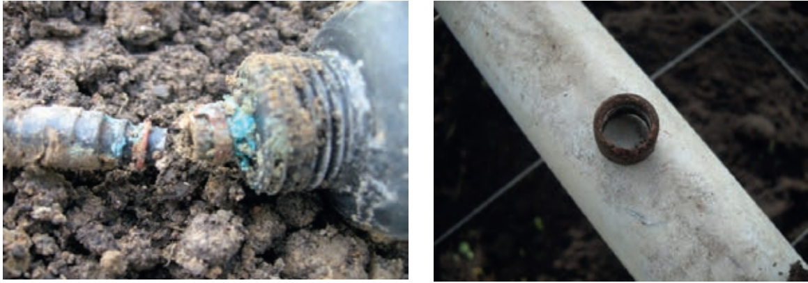
Figuur 18. Gecorrodeerde SM200 sensor (links), aangetaste metalen ring van SM300-connector.
