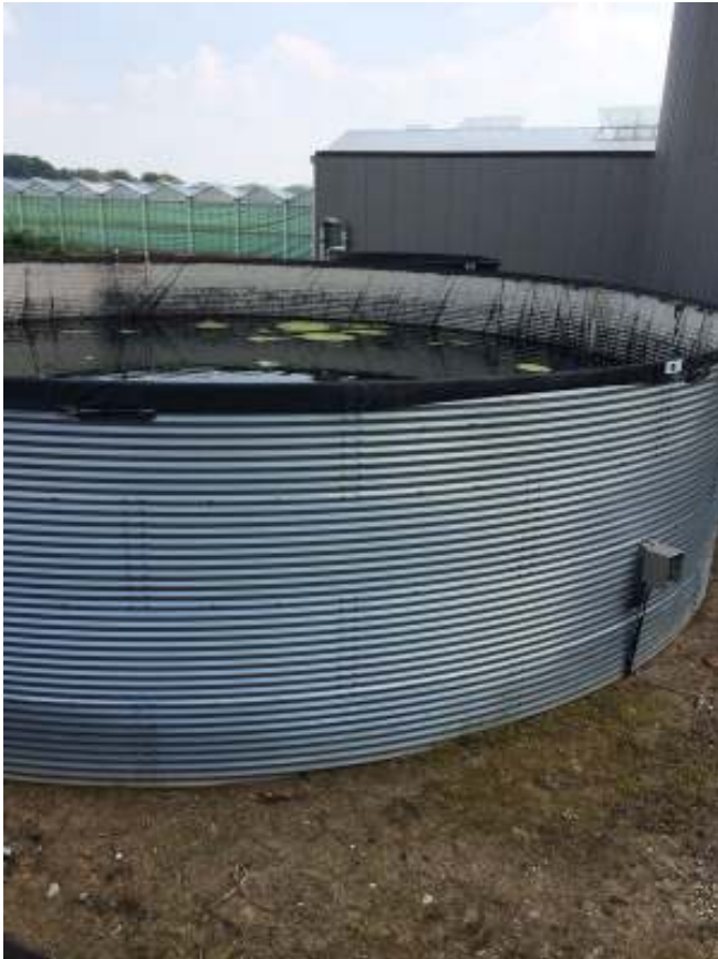
Figuur 15. Silo met drainagewater.
