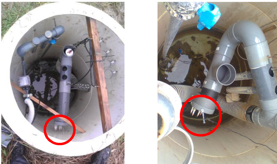
Figuur 4.11: Installatie van de Flow-Caps. Links: eerste opstelling (tot 22 februari 2013); rechts: tweede opstelling (vanaf 22 februari 2013), met nooduitlaat.
