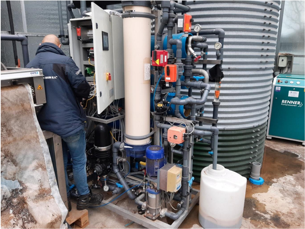
Figuur 2-2 Doekfilter als voorfiltratie voor het zinkmembraan zoals geplaatst bij Fransen Orchideeën.
