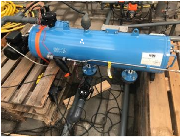
Figuur 2-2 Filterstraat 2 met één filterstap (A).
